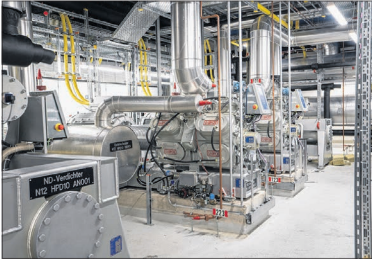
Die Abwärme aus der ARA Birs versorgt dank den zwei leistungsstarken Wärmepumpen unterschiedliche Liegenschaften.
